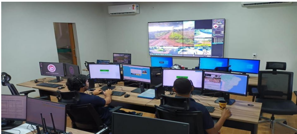
Figura 28: Sala do Centro de Atendimento e Despacho de Urgências no 15º Batalhão de Polícia Militar, Itaituba, em 2023.
